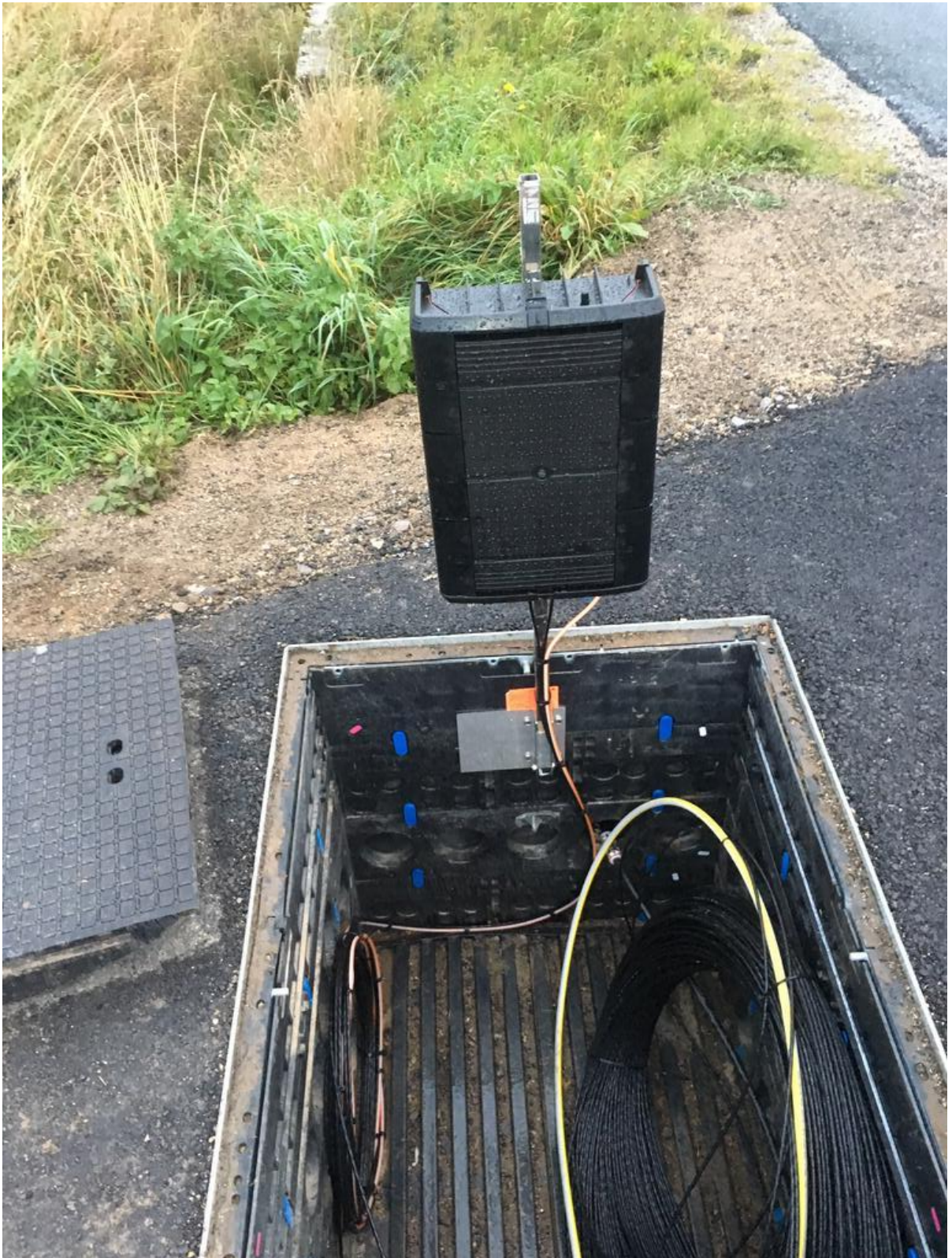
Abbildung 4: Schacht inkl. Spleißkassette, Gemeinde Karlstein an der Thaya
