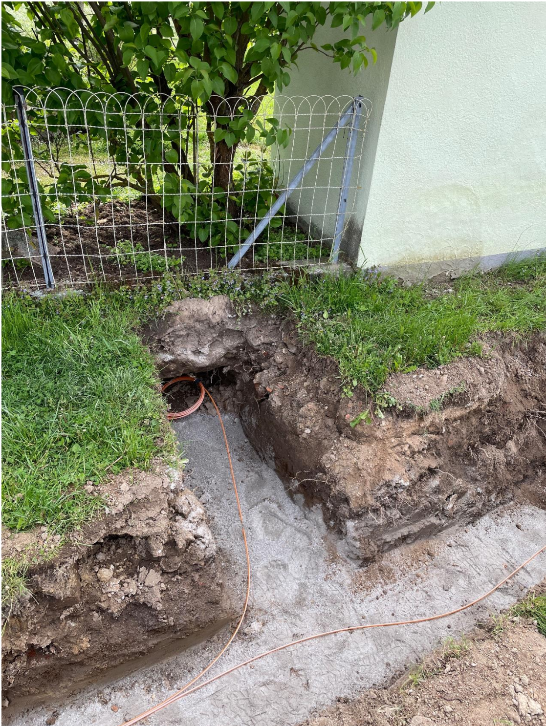
Abbildung 5: 2 Einzelröhrchen, 1x Verlegung zur Grundstücksgrenze, Gemeinde Waidhofen an der Thaya
