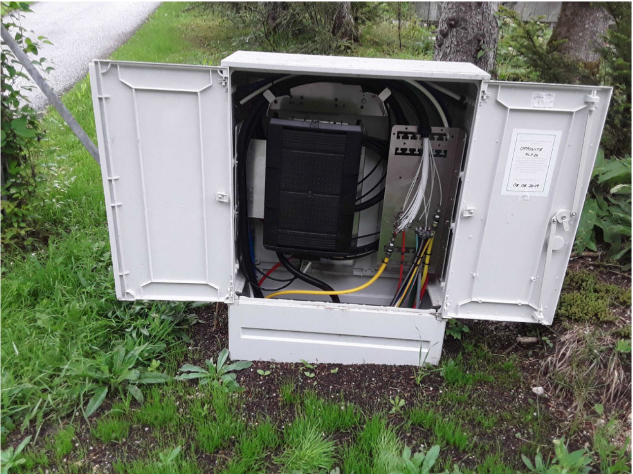
Abbildung 3: FCP mit Leerrohren und Spleißkassette; Gemeinde Opponitz
